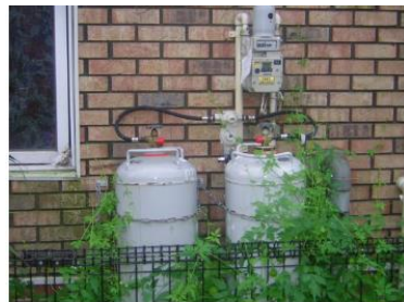
防止傾倒措施 (鐵鍊、柵欄等)
