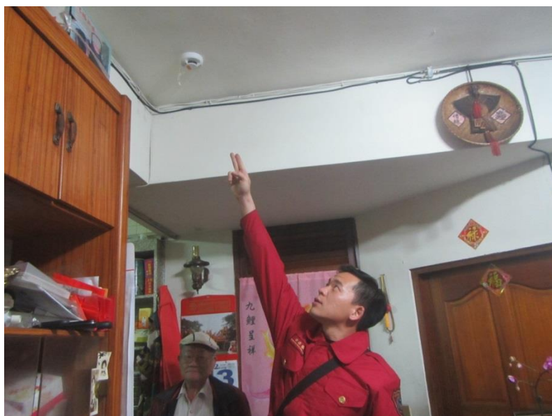
圖三：住警器裝設位置
